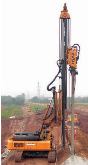
Schmalwandherstellung mit RG 18T, Mainz Construction of VIB-wall with RG 18T, Mainz, Germany
